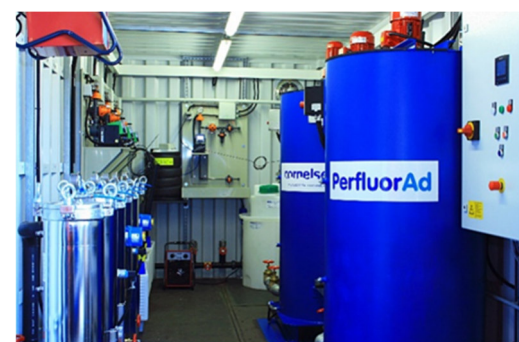
Abbildung 5: Blick in die mobile PerfluorAd-Anlage von Cornelsen
